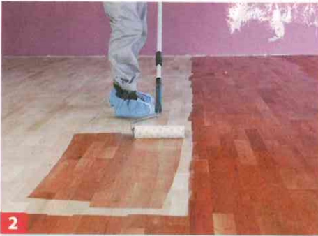
2 Für die Fläche eine Auftragswalze mit Stiel nutzen. Arbeiten Sie immer bahnenweise zur Tür hin! Nach etwa 15 Minuten matte ...
